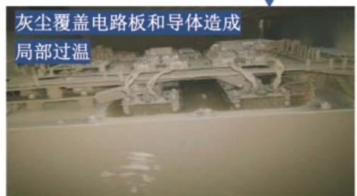
灰尘造成的电柜隐患
