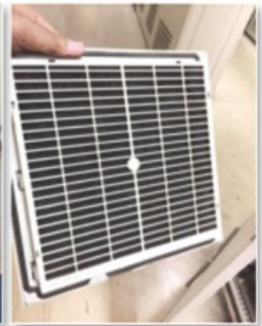
中控室DCS系统柜积满 灰尘的IP5X过滤风窗
