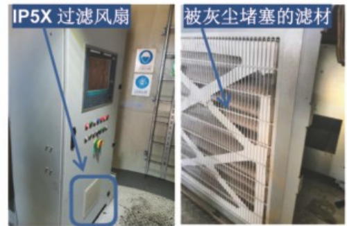
风机电柜_灰尘堵塞滤材
